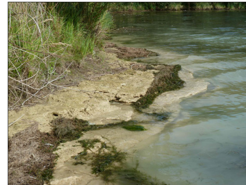
Photo 32 : Berge érodée et peu végétalisée
